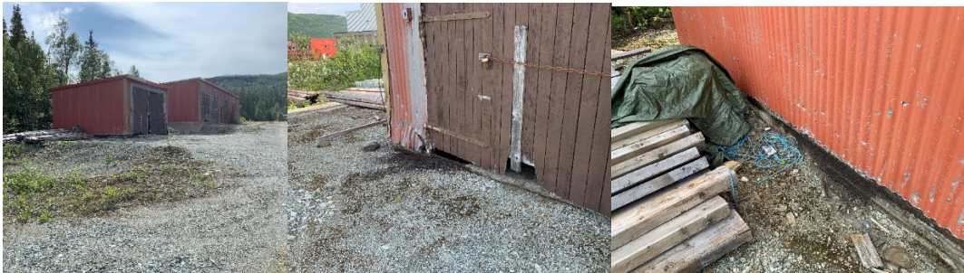
Figur 5-12: Fra venstre: Smøremiddelbu og snekkerverksted, synlig lekkasje foran smøremiddelbu, synlig lekkasje ved siden av smøremiddelbu.
