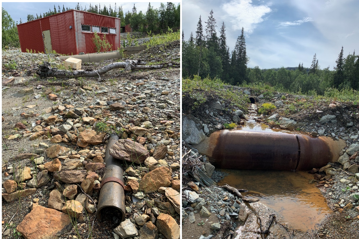
Figur 5-30: Venstre: Rør på stranden. I bakkant skimtes kum og rør som leder bekk utenom gråbergtipp. Det røde bygget er pumpehus med kloakkrensning. Høyre: Rør som leder bekk forbi gråbergtipp.
