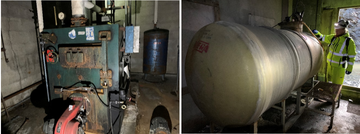
Figur 5-32: fyringsanlegg og oljetank ved inngang til hovedstoll.
