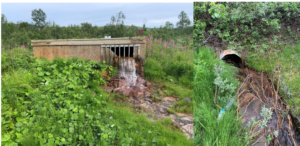
Figur 4-8: Forurenset vann fra dagbrudd og gruve strømmer kontinuerlig ut fra Stigort 4 (venstre bilde) til bekk (høyre bilde) som renner direkte ut i Orvasselva.
