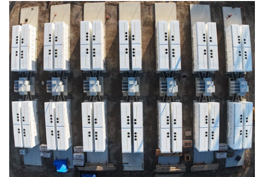
Pome i San Diego, Kalifornien, är Eolus andra renodlade batterilagerprojekt. Läs mer om projektet på sidan 37.
